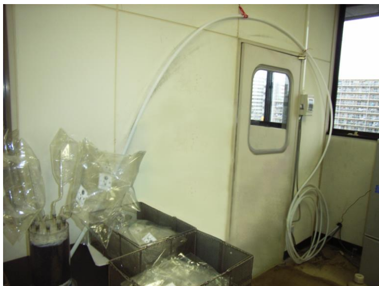
空冷方式の実例（ポリふっ化樹脂製チューブ約 10m） （ポンプは大型のためベランダに設置している）
